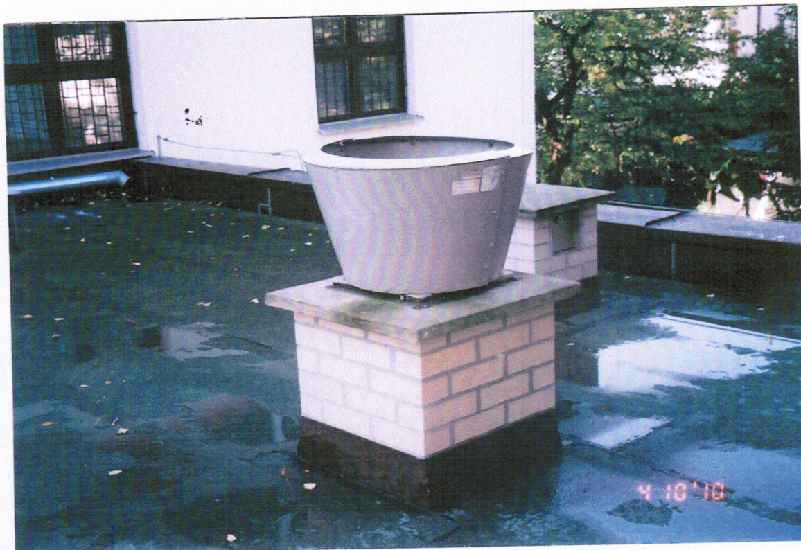
Rys.15z Widok w kierunku starego budynku i kałuże po wylaniu niewielkiej ilości wody
