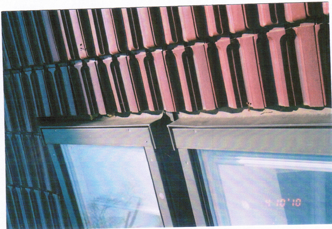
Rys.23z Zbyt wąska szczelina pomiędzy górną poziomą krawędzią okna i dachówką
