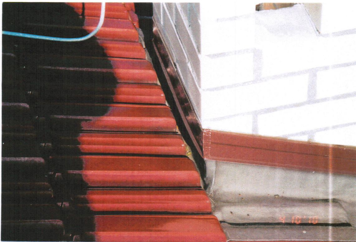
Rys.33z Jak rys.32z, widok z drugiej strony komina, zbyt wąska szczelina pomiędzy kominem i dachówkami
