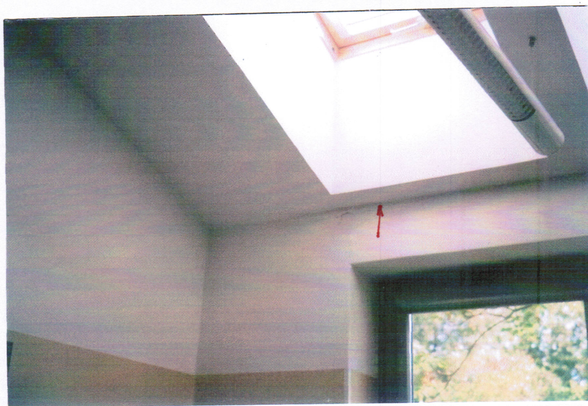
Rys.6z Jak rys.5z, zaciek pod lewym oknem
