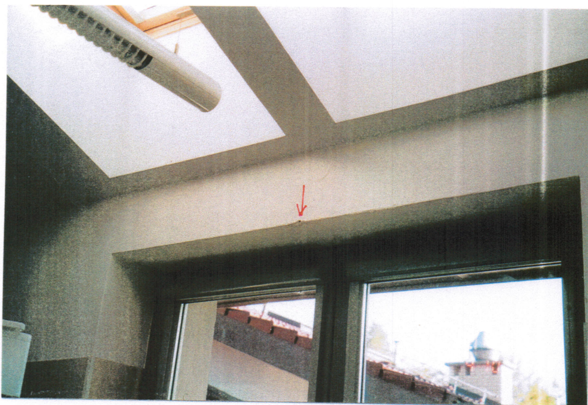
Rys.8z Pokój 156, ślady zacieków pod oknami połaciowymi oraz złuszczenie tynku na krawędzi nadproża
