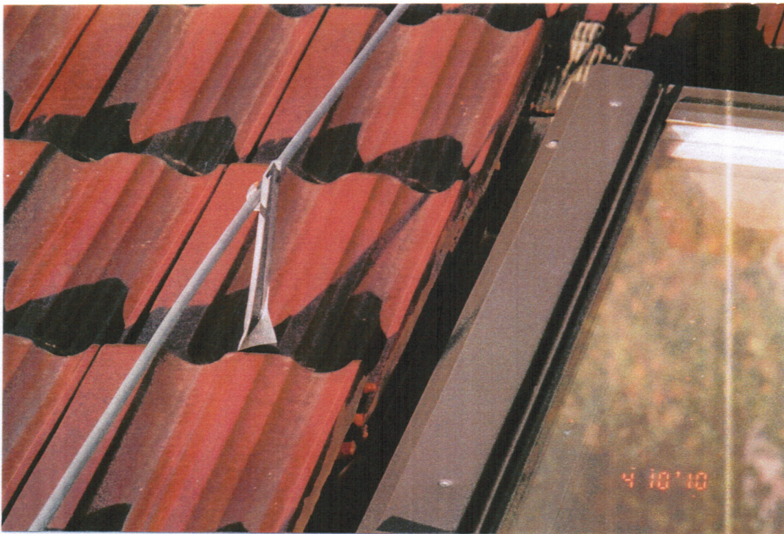
Rys.25z Krawędź podłużna okna, dachówki nie zachodzą na rynienkę, spadek dachu zgodnie z kierunkiem cienia
