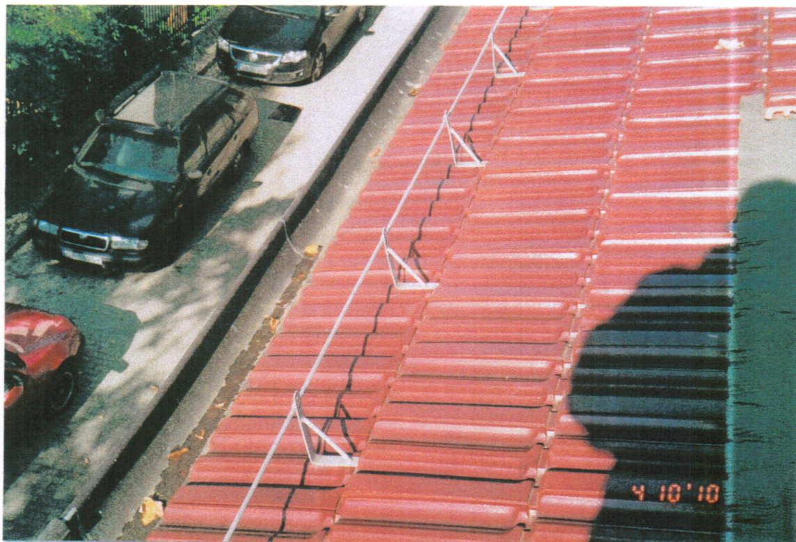
Rys.35z Zanieczyszczenie rynny świadczące o konieczności regulacji jej spadku
