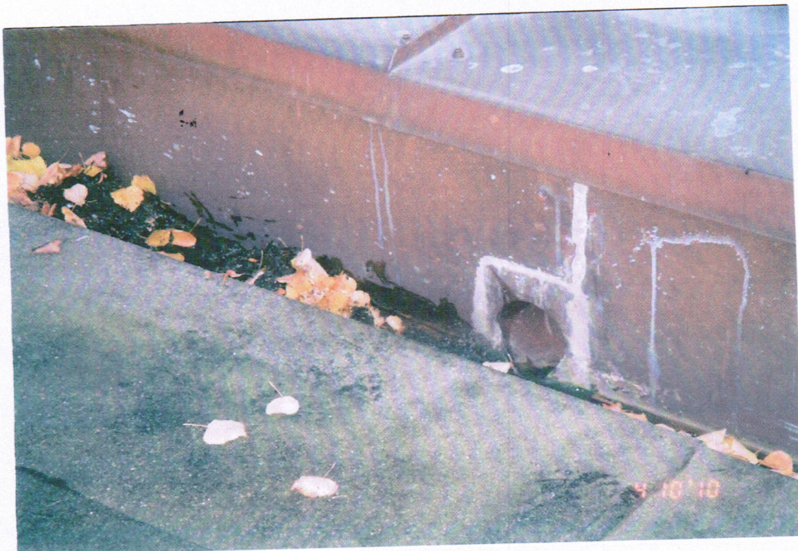
Rys.13z Jak rys.12z, bardzo płytka (około 3 cm) i zaśmiecona rynna wzdłuż attyki, odpływ z rynny do kosza \varnothing 10 cm (poziomej rury spustowej \varnothing 12 !), na łączeniach papy zgrzewalnej brak wymaganego ciągłego wypływu bitumu (patrz dolny lewy narożnik)
