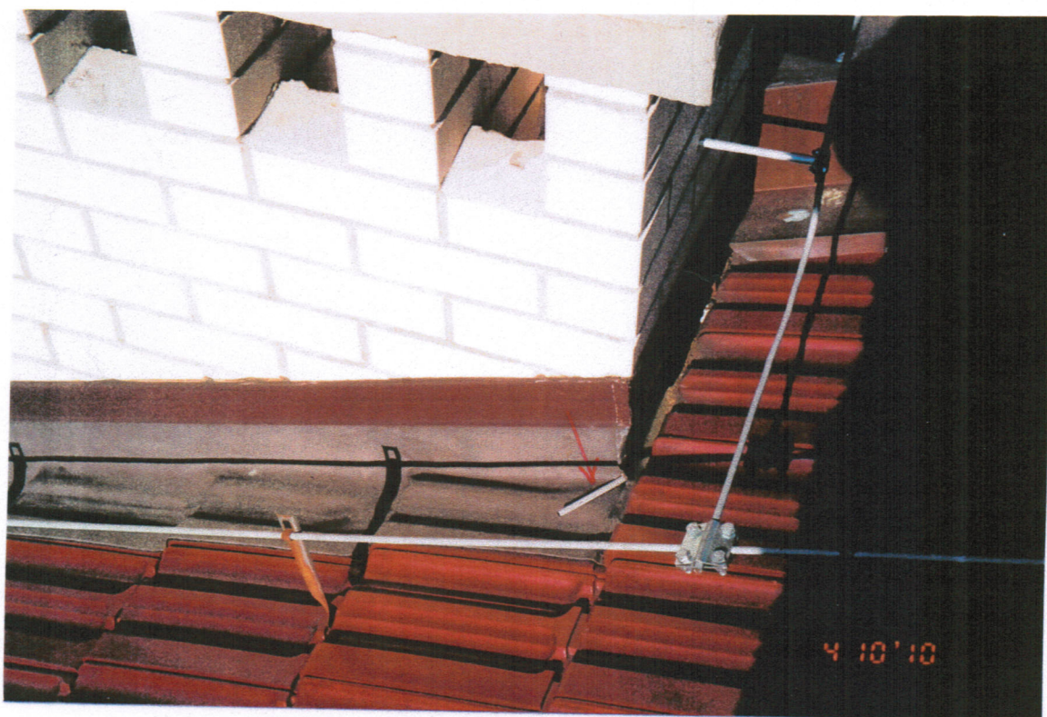
Rys.32z Obróbki blacharskie przy kominie, zbyt wąska szczelina pomiędzy dachówkami i poziomą górną krawędzią komina, widoczne lico ceglane wskazuje na bardzo małe pochylenie dachu, które wynosi tylko 21^\circ (lub 38%), wymagane min. 27^\circ (lub 50%), w dolnym prawym narożniku komina jest w obróbce blacharskiej otwór (włożony ołówek)
