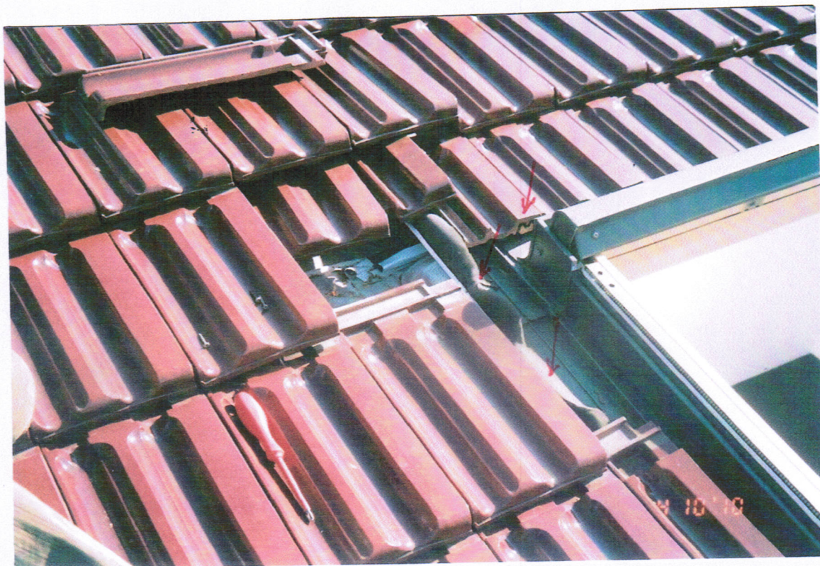
Rys.21z Odkrycie dachówek przy oknie - wyłazie na dach z pokoju 163, widoczne górne zakończenie dachówki, przyduszona pianka pod dachówką (powinna być odchylona w kierunku okna) oraz połączenie podłużne pomiędzy dachówkami (przy górnym narożniku)
