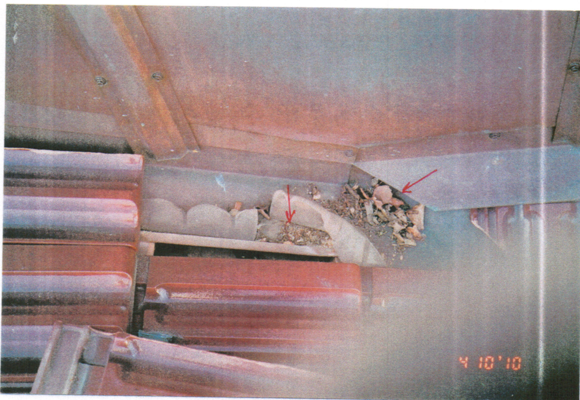
Rys.37z Odslonięcie dachówek ułożonych równoległe do świetlika, widoczne śmieci i niestarannie ułożona pianka izolacyjna
