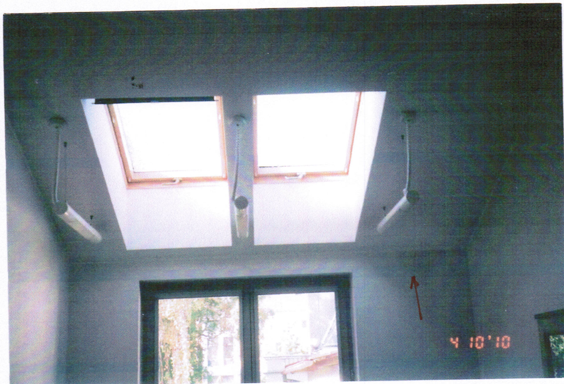
Rys.3z Pokój 163, zaciek w prawym narożniku
