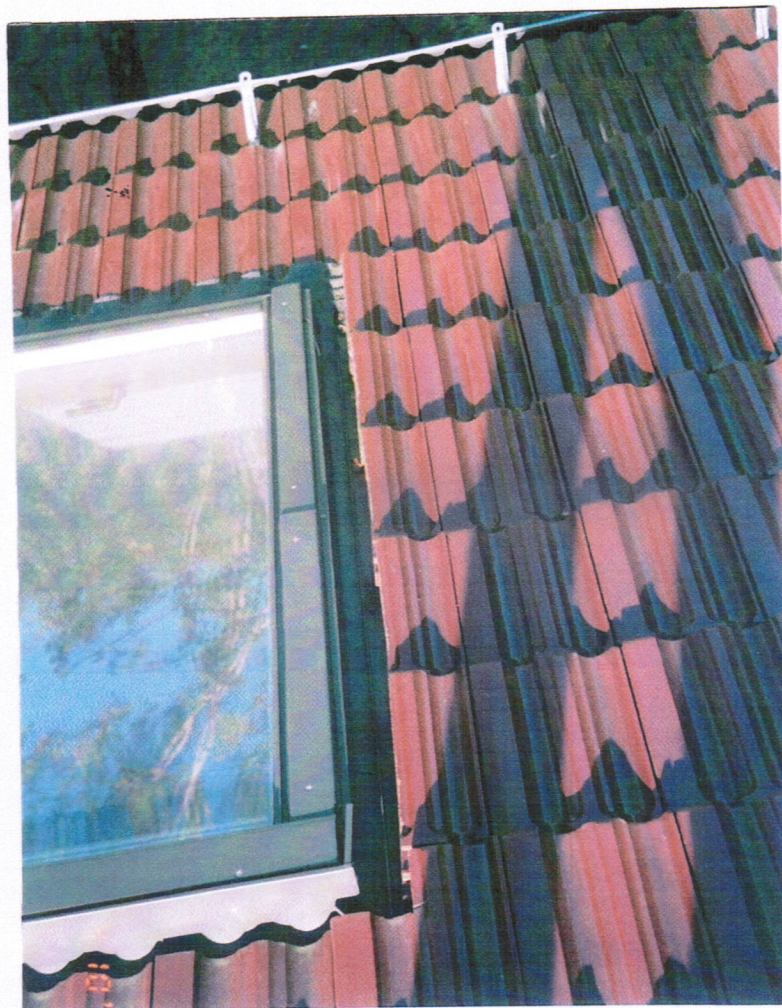
Rys.19z Widok okna połaciowego, spadek dachu w kierunku instalacji odgromowej, dachówki nie zachodzą na rynienkę odwadniającą wzdłuż podłużnej krawędzi okna
