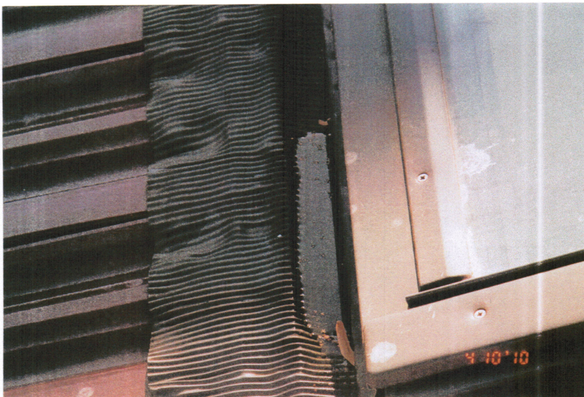
Rys.27z Fartuch przy dolnej poziomej krawędzi okna (spadek w lewo), kałuża wody z deszczu przed kilkoma dniami spowodowana zbyt małym pochyleniem dachu
