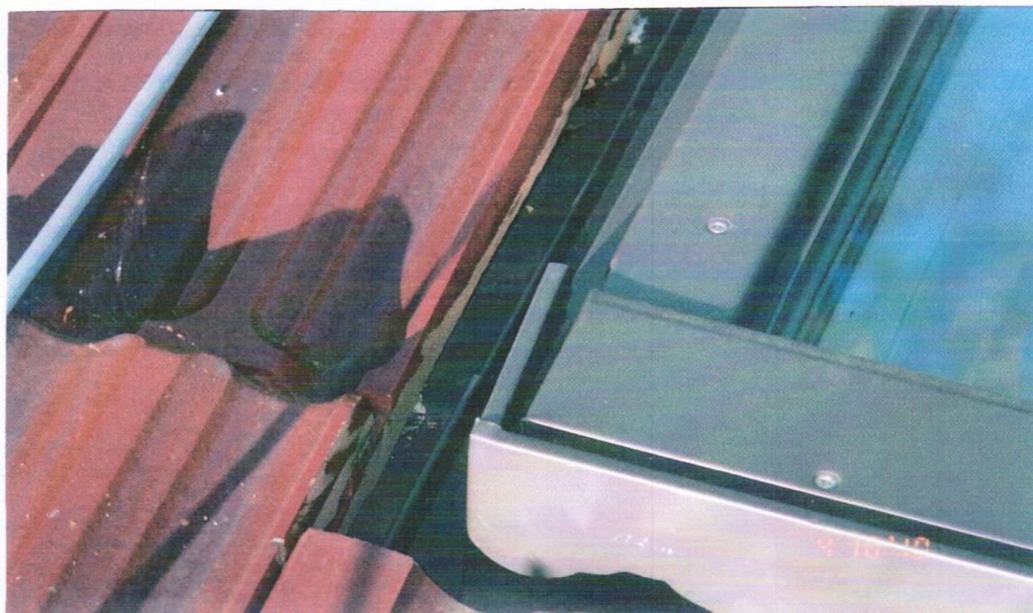
Rys.20z Jak rys.19z - lewy górny narożnik okna, dachówki nie zachodzą na rynienkę
